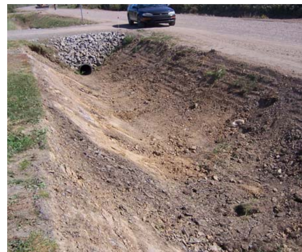
Fossé dénudé du rang des Érables, Photo Mathieu Gagné
