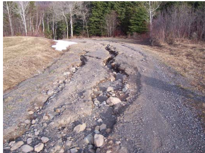
Photo : Érosion du chemin 16 avril 2010, Mathieu Gagné
