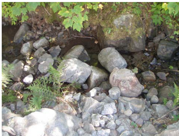
Éboulement dans le cours d'eau TP-04 causé par les travaux de rénovation
