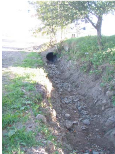
Aspect du fossé du chemin de l'Érablière près de la jonction avec le chemin des Érables
